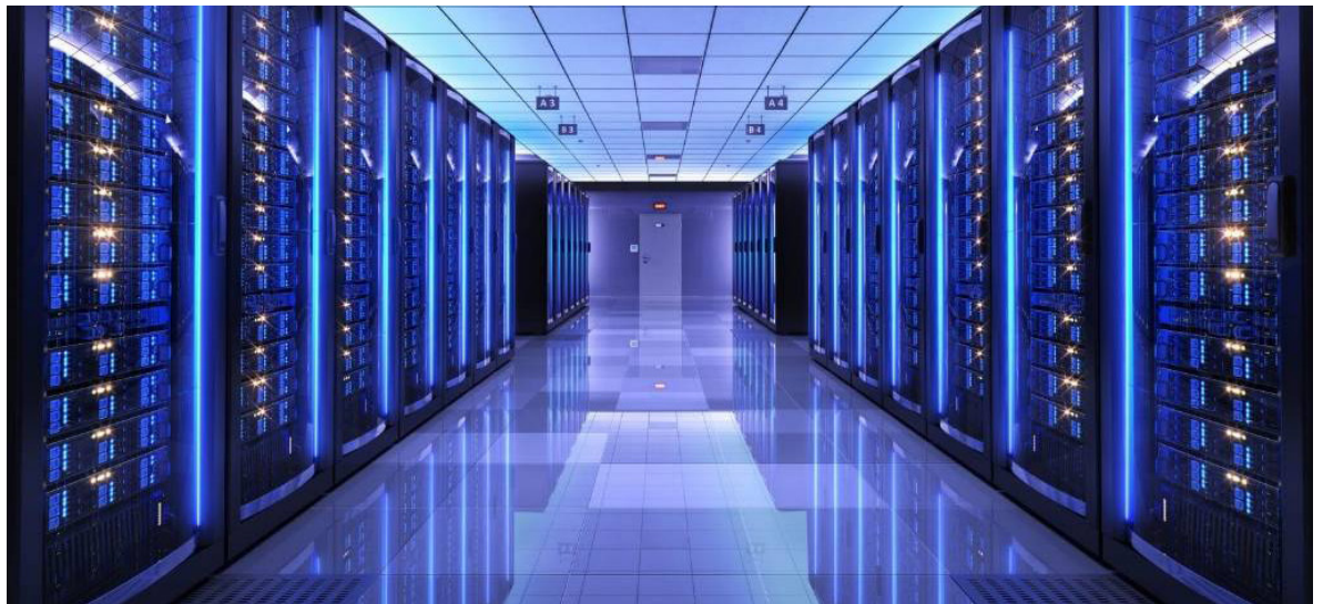
Photographie d'un datacenter
