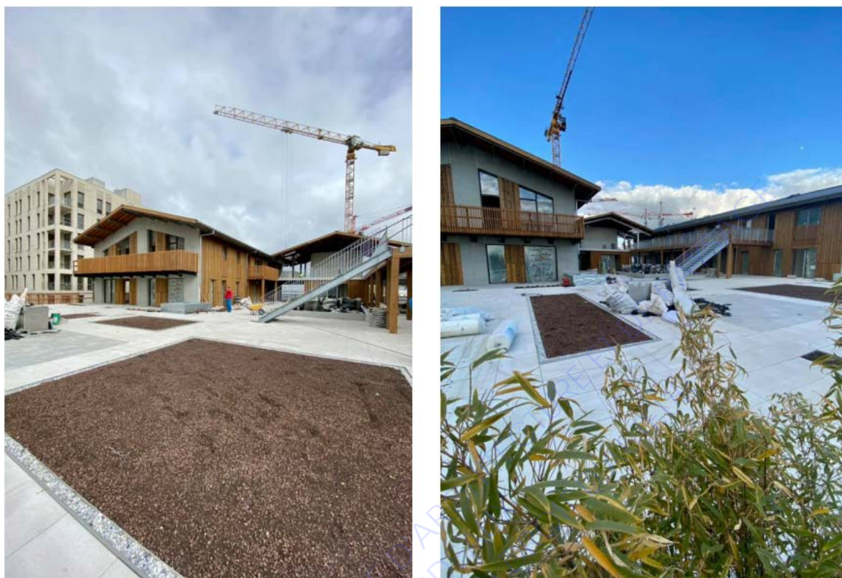
Figure 19 : Photographie de la résidence en construction, vue sur le premier niveau où se développe la terrasse partagée intégrant les jardins collectifs.
