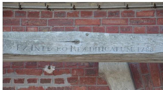
Figure 116 : Poutre retrouvée lors de la rénovation du bâtiment qui abrite aujourd'hui le musée de Corbie. ©Maxence Toubin
