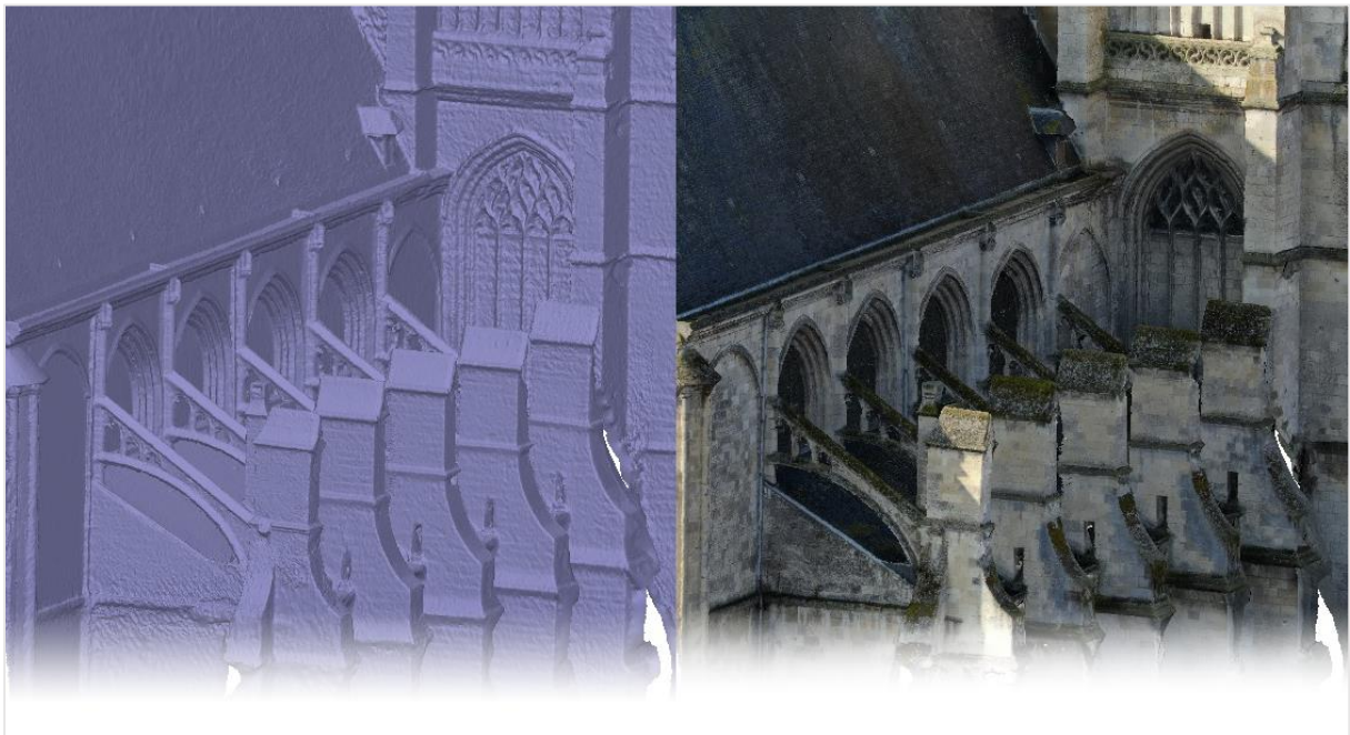
Figure 34 : Relevé photogrammétrique du collatéral nord de l'église Saint-Pierre au niveau des arcs-boutants. ©Maxence Toubin
