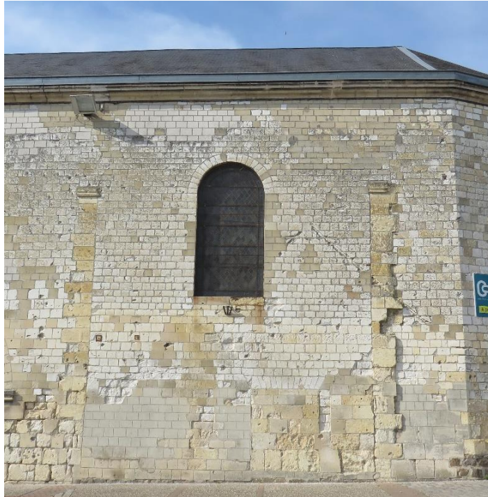
Figure 67 : Vue des vestiges sur le mur sud du bâtiment actuel. ©Maxence Toubin
