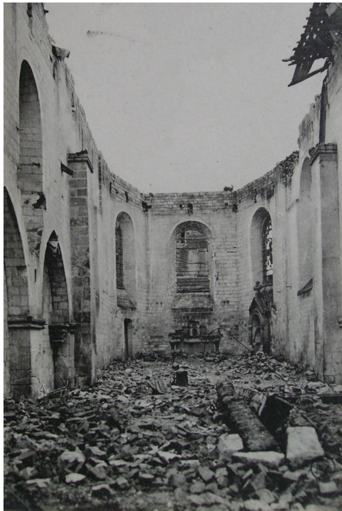
Figure 68 : L'église Saint-Étienne, convertie en orphelinat, après les bombardements de la Première Guerre mondiale
