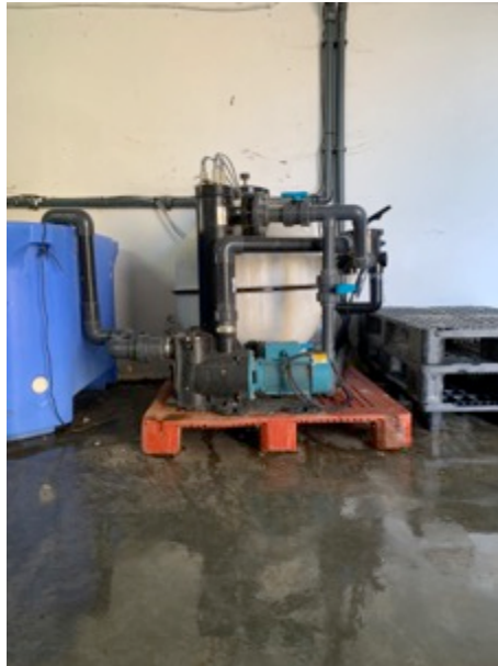
Figure 27 – Filtre à sable installé chez un ostréiculteur corse pour purifier l'eau pompée dans l'Etang de Diana afin d'assurer un stockage des huîtres sûr et sain (photographie prise en février 2022)
