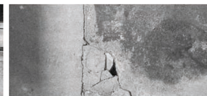
La paroi de l'escalier est fissurée
