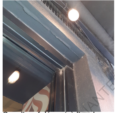
Sac d'oeuf déposé à l'angle supérieur d'une menuiserie aluminium.
