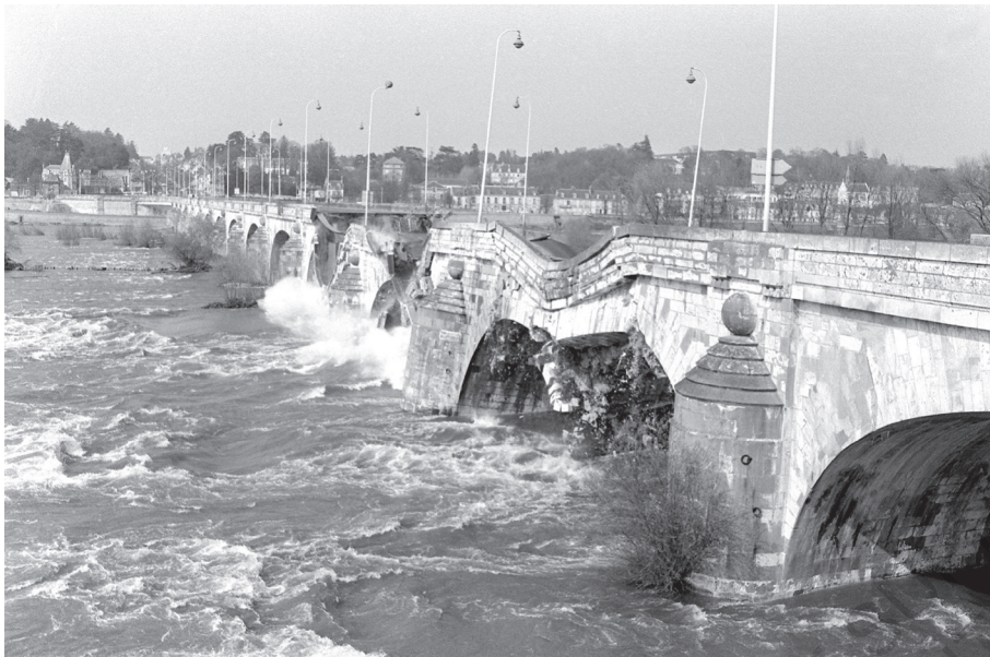
Fig. 7. Effondrement du Pont Wilson à Tours
