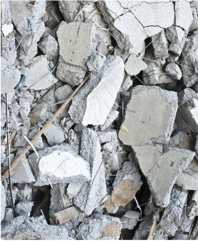
Figure 78 : Béton démolit et ferrailles. Inconnu.
