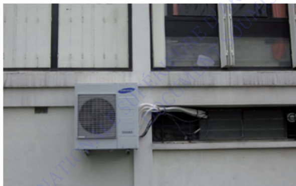
Figure 26 : Climatiseur d'un commerce, rejetant de l'air chaud dans l'atmosphère (APUR, 2012)
