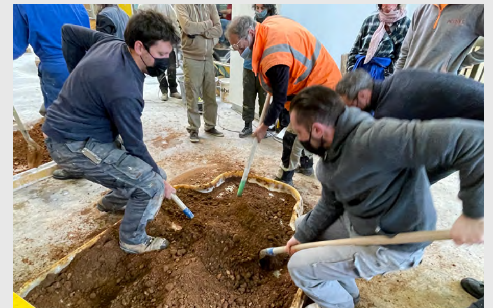
Partage d'expertise et de savoir-faire entre participant-e-s. Lors de l'atelier, trois maçons spécialisés dans la rénovation du bâti ancien montrent à leur camarades les gestes pour réaliser un bon mélange à la pelle.
