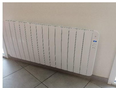
Figure 121 : Radiateur de la cantine "inutile" photographié par un garçon
