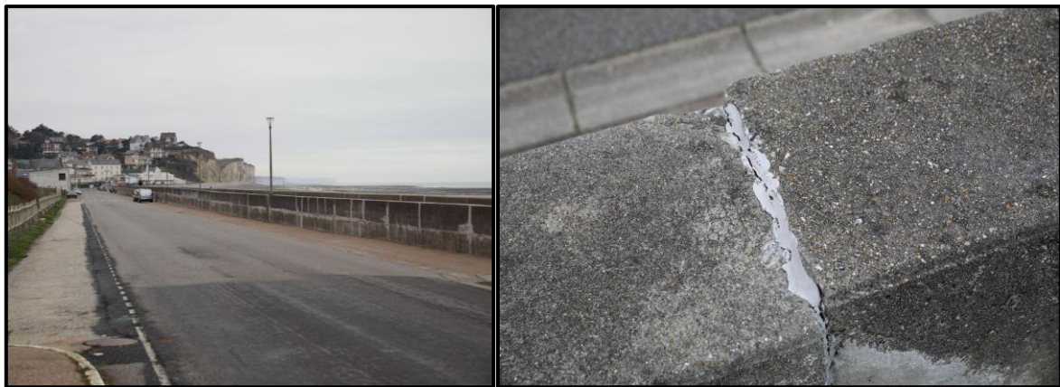
Fig. 16 : La digue de Quiberville et ses fissures, G. DELSIGNE, 2023.
