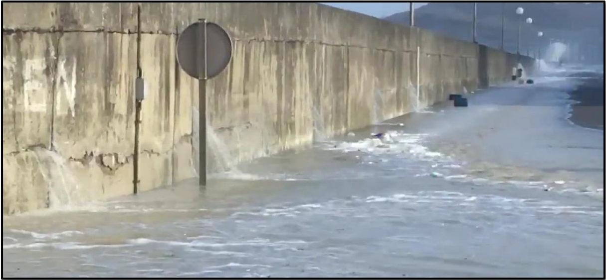
Fig. 61 : Fissures de la digue route de Quiberville, J. FAVREL, 2018.
