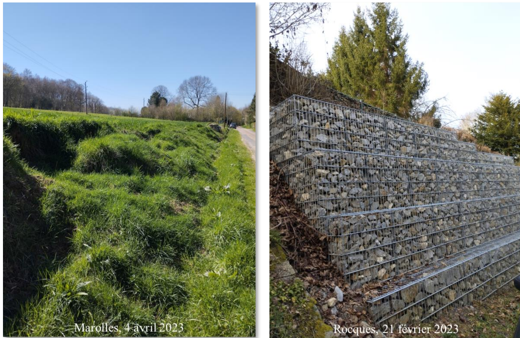
Figure 27 : talus éboulé à Marolles qui bouche le fossé et gabions qui soutiennent un talus (C. GAMBU, 2023)
