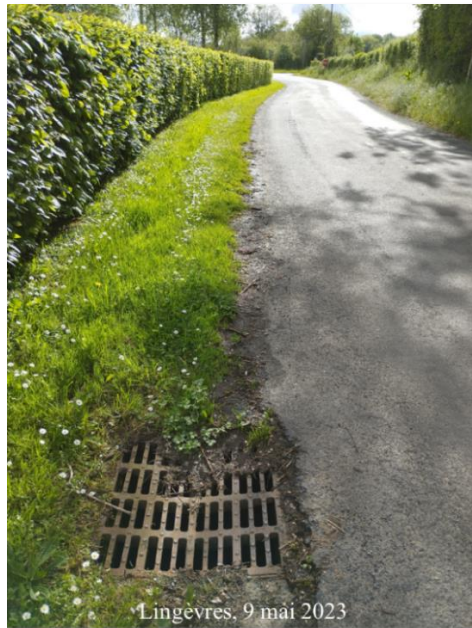
Figure 29 : avaloir qui draine l'eau qui ruisselle sur la route (C. GAMBU, 2023)
