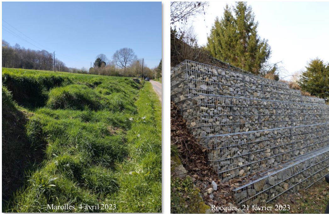
Figure 27 : talus éboulé à Marolles qui bouche le fossé et gabions qui soutiennent un talus (C. GAMBU, 2023)
