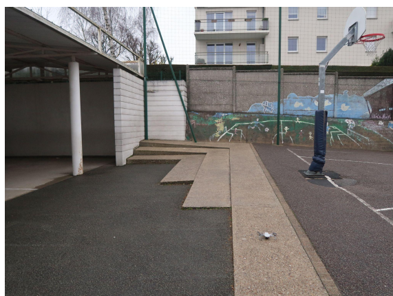
Fig. 25 : Photographie des emmarchements accidentogènes situés entre le terrain multisport et le préau - Arc en Terre (document interne) - Mars 2023
