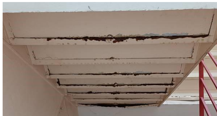
Photographie 1 Escalier corrodé copropriétés des Plantées Meyzieu
