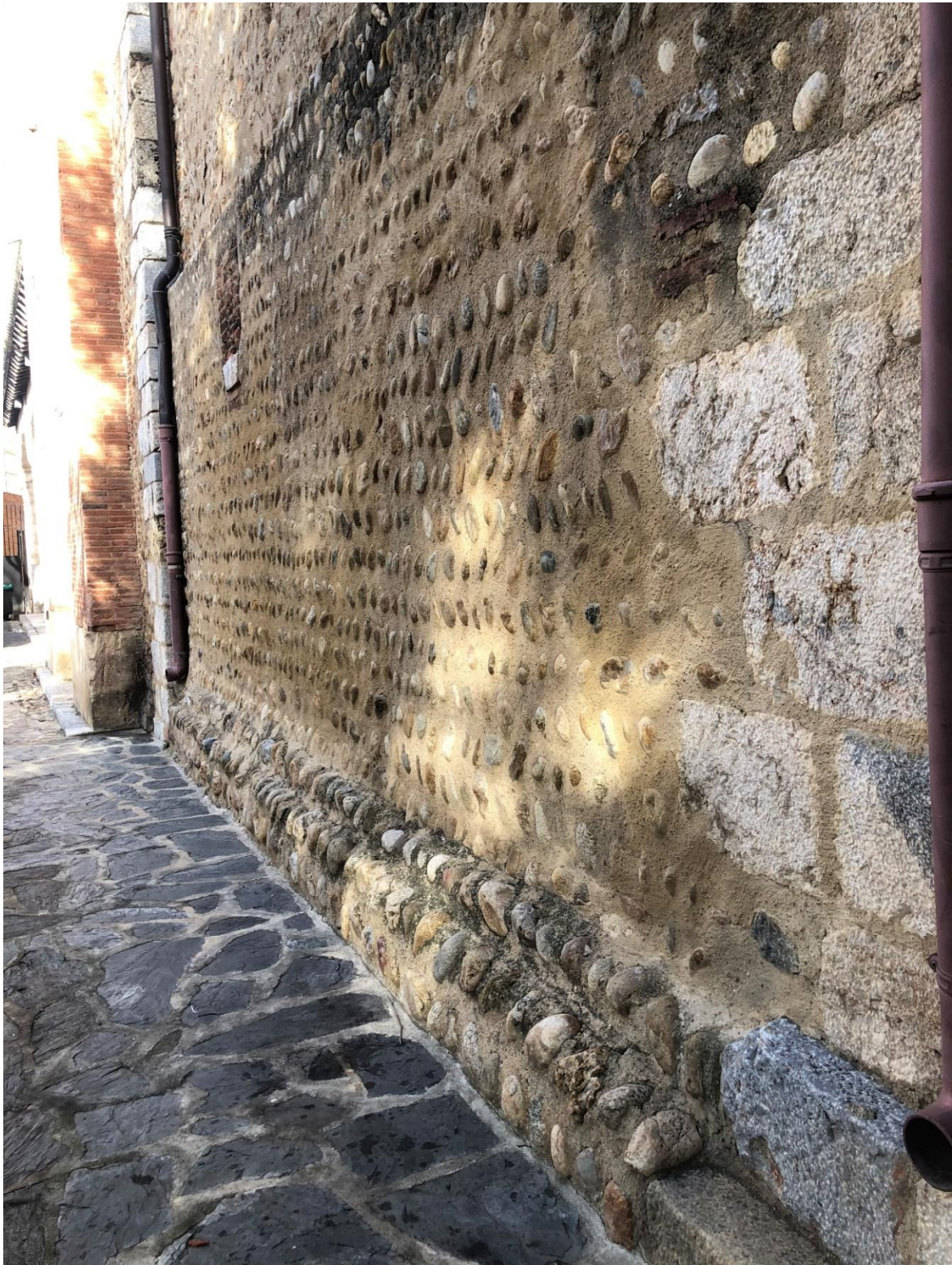
Figure 67 : Détail du mur de la chapelle du Saint Sacrement, cliché N. Roques
