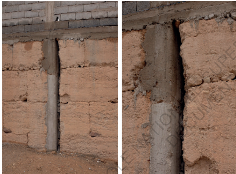
Exemple de décollement du pisé adjoint à une surface en béton, propice aux infiltrations ©N.C.
