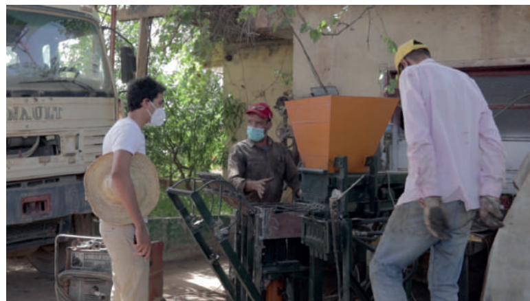
Mise en place de la presse hydraulique pour la création des BTC. Août 2021. ©ateliergemine
