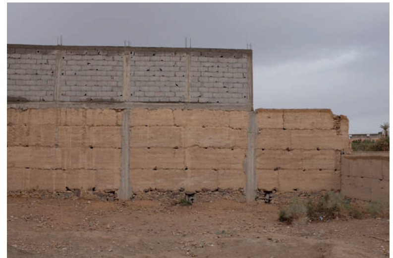
Quelques construction à Icht. Pierre en fondation/soubassement, pisé pour le premier niveau adjoint au poteau poutre en béton, parpaing sur le niveau supérieur ©N.C.
