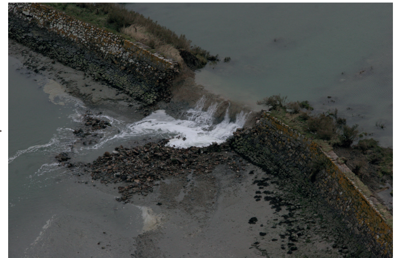
DREAL Pays de la Loire, Rupture de digue à Guérande (tempête Xynthia), Guérande 2010 , photographie
