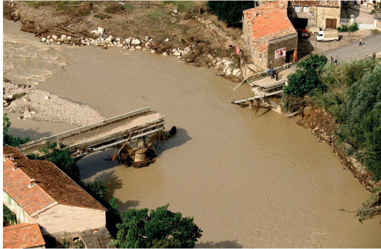
ESPOSITO Ange, À Roaix, le pont a été un des 11 ouvrages emportés par la crue, 1992, photographie
