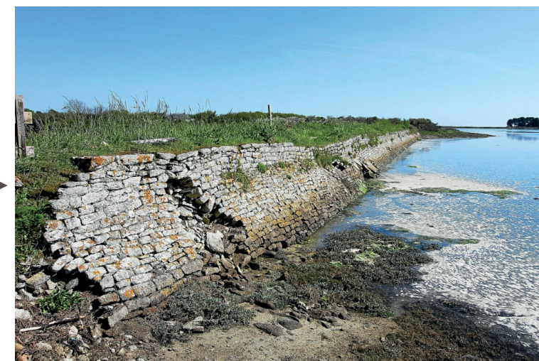
THEALLET Patrick, La digue de Kerescant est en très mauvais état mais des travaux sont prévus cette année., 2022, photographie
