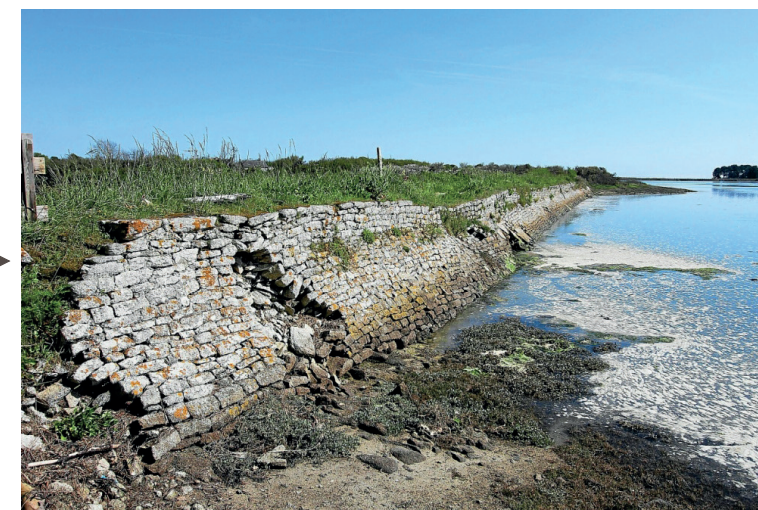
THEALLET Patrick, La digue de Kerescant est en très mauvais état mais des travaux sont prévus cette année., 2022, photographie
