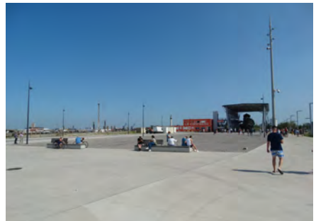
Fig 63- La partie non bitumée représente l'emprise au sol de la future nef
