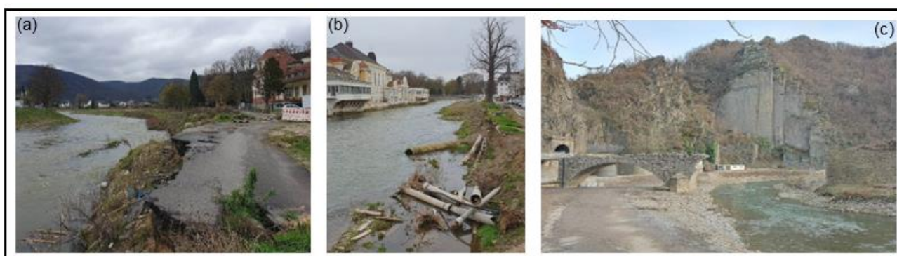
Figure 11 : Dommages causés par le passage de la crue sur les routes (a), les canalisations (b), et les ponts (c), (photographies : S. Bouchenaki, 2023)
