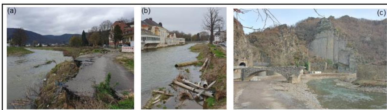
Figure 11 : Dommages causés par le passage de la crue sur les routes (a), les canalisations (b), et les ponts (c), (photographies : S. Bouchenaki, 2023)
