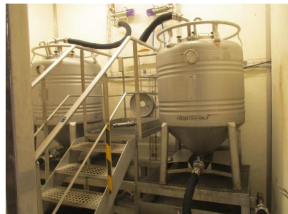
Figure 1 : Vue intérieure de la station quai déchets
