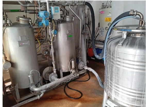
Figure 4 : Vue intérieure de la station quai déchets
