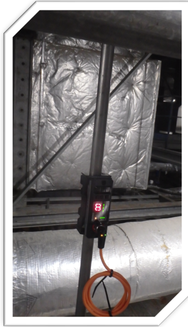
Figure 10 : Photo d'un capteur du système West-Arc placé à l'extérieur du tuyau
