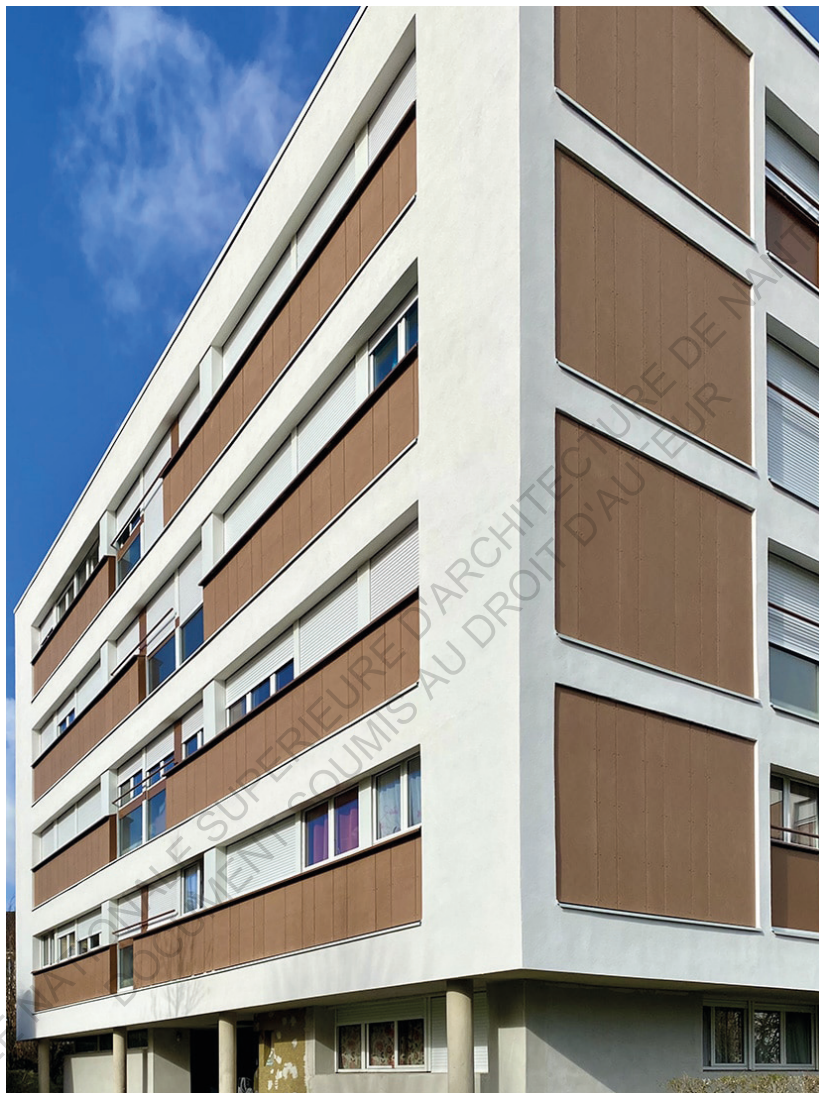
Photo des façades d'un immeuble du projet après rénovation thermique., Fontenay-aux-Roses, Hauts-de-Seine 156 .
