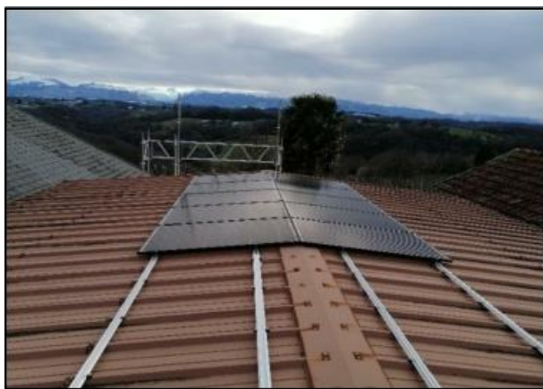
Figure 2 - panneaux solaires photovoltaïques au Clos Mirabel
