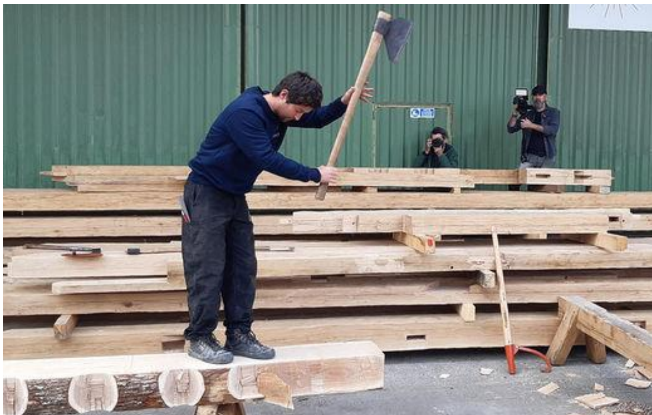
Figure 70 - Restauration de Notre-Dame : Quelques 20 km d'arbres sont transformés en poutre à la hache de dégrossi et à la doloire (source : Jean-Philippe Defawe via Le Moniteur)
