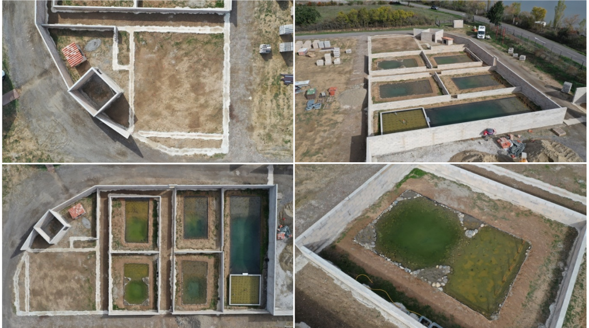
Figure 26 : Photographies aériennes de la station d'élevage et d'étude en cours de construction - © Fred Lavail
