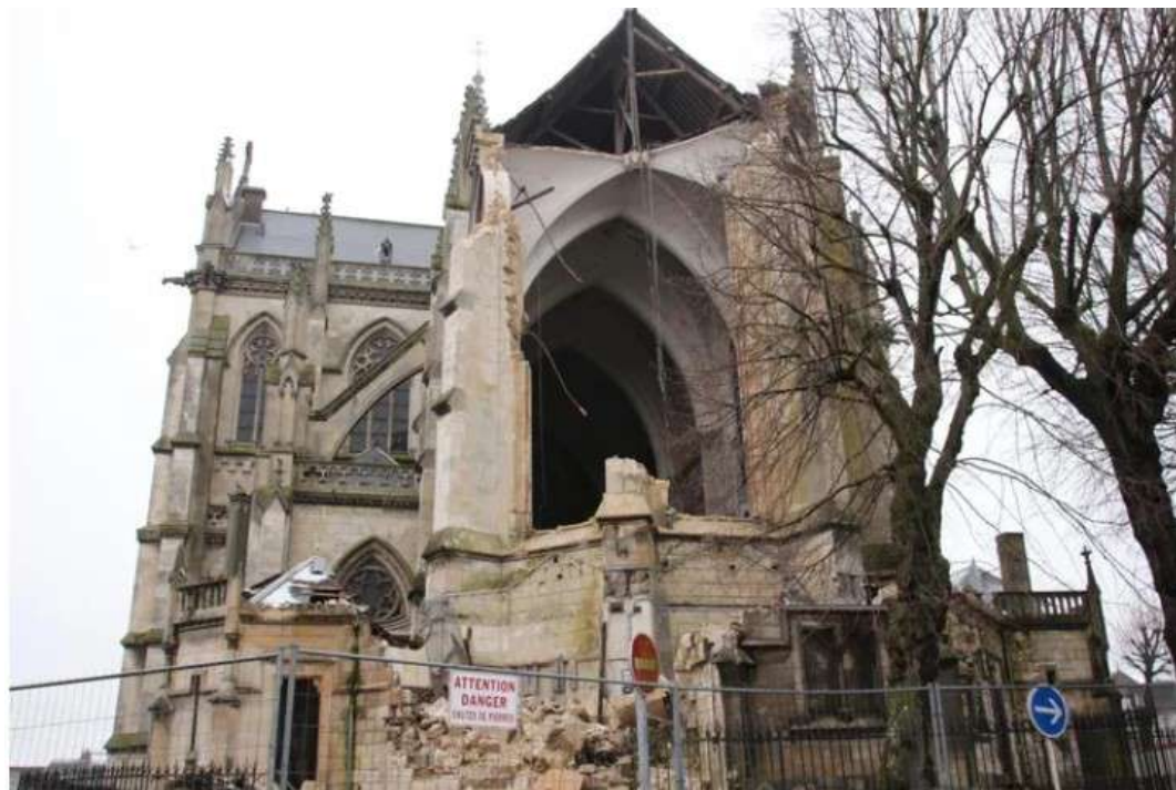
Fig.43. : Agnès Charenton, Chevet de l'église Saint-Jacques d'Abbeville en partie détruit, photographie numérique, dans « À Abbeville, la démolition de l'église ébranle les habitants », La Croix, 19 février 2013 p.19., février 2013.
