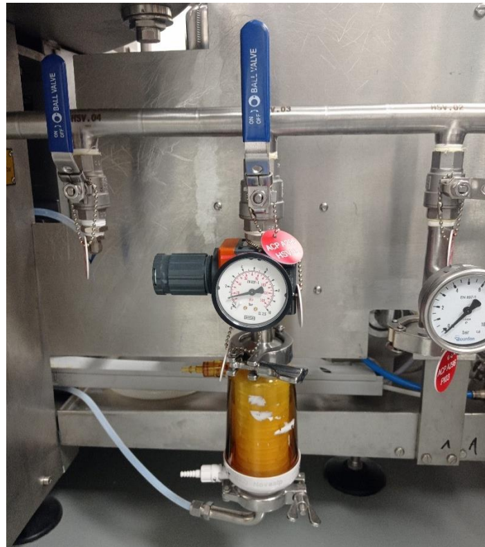
Figure 15 : arrivée d'air comprimé en laveuse.
