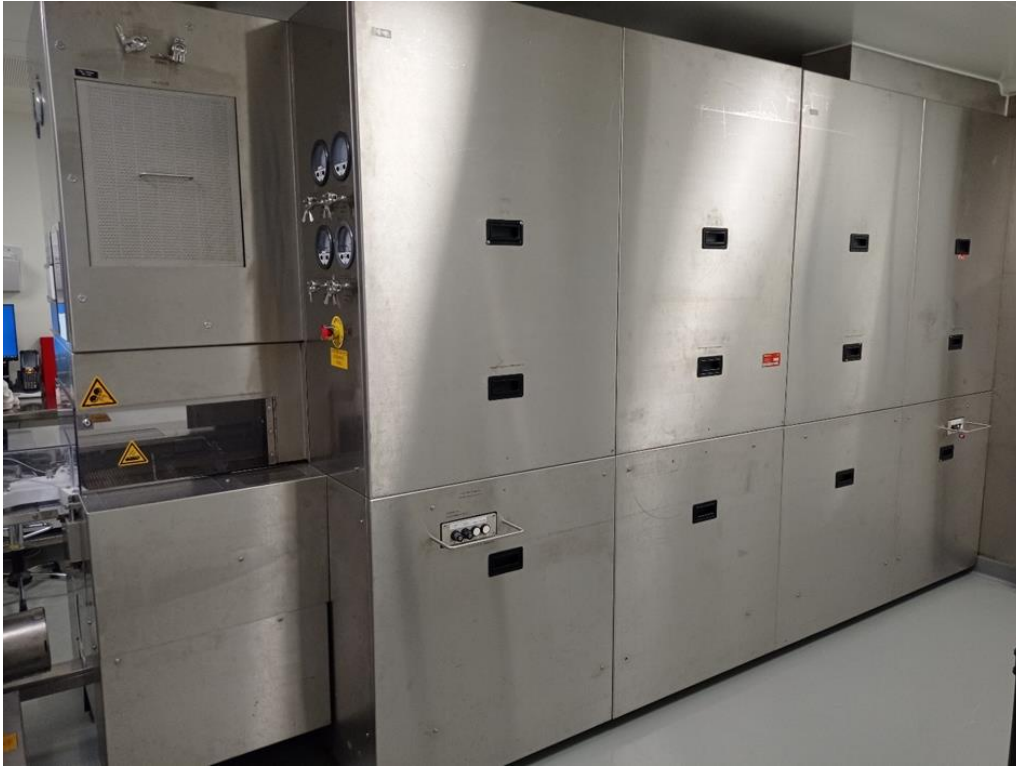
Figure 18 : vue d'ensemble du tunnel de stérilisation-dépyrogénéation.
