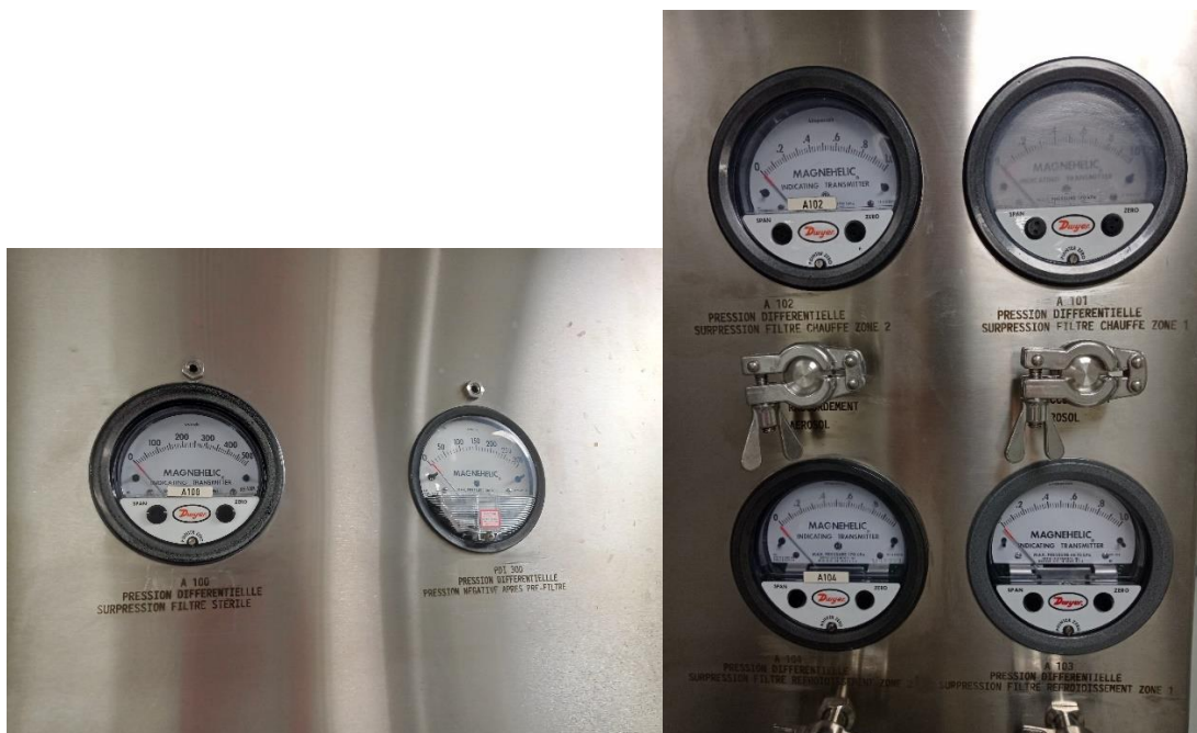
Figure 20 : manomètres du tunnel de stérilisation-dépyrogénéation.
