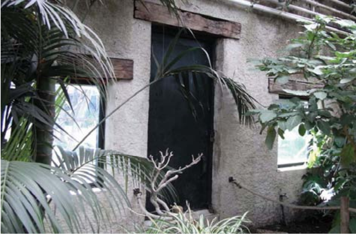
Photo 34 : Porte en acier galvanisé pleine, permettant un accès direct sur une île pour orang-outan. Remarquez la présence de grande fenêtre de part et d'autre de la porte permettant un contrôle visuel de l'ensemble de l'espace avant l'ouverture de la porte (ZooParc de Beauval) [Original]
