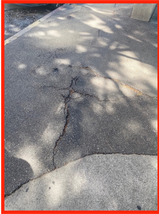
Figure 7 : sol fissuré présentant un obstacle
