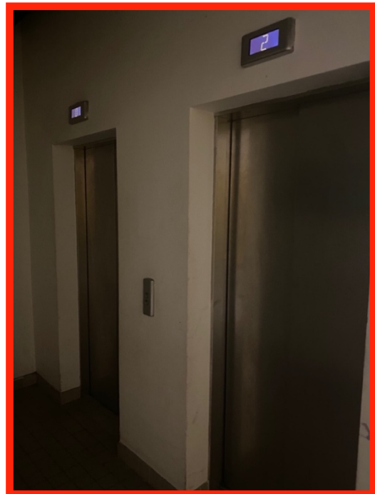
Figure 54 : ascenseurs du service non éclairés
