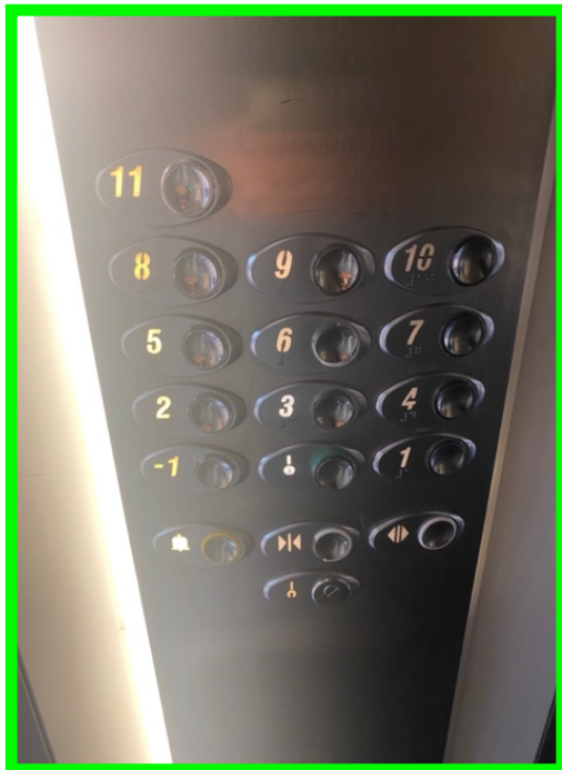
Figure 41 : boutons des étages des ascenseurs
