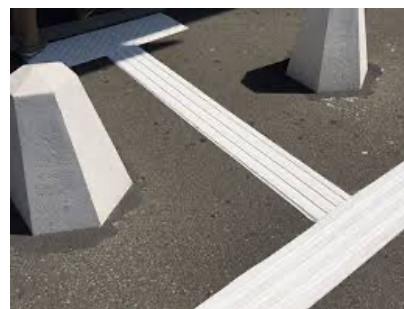
Bande de guidage podotactile
