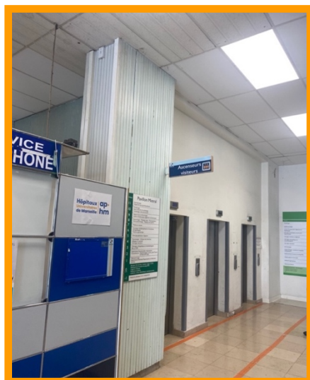
Figure 38 : ascenseurs du rez de chaussée
