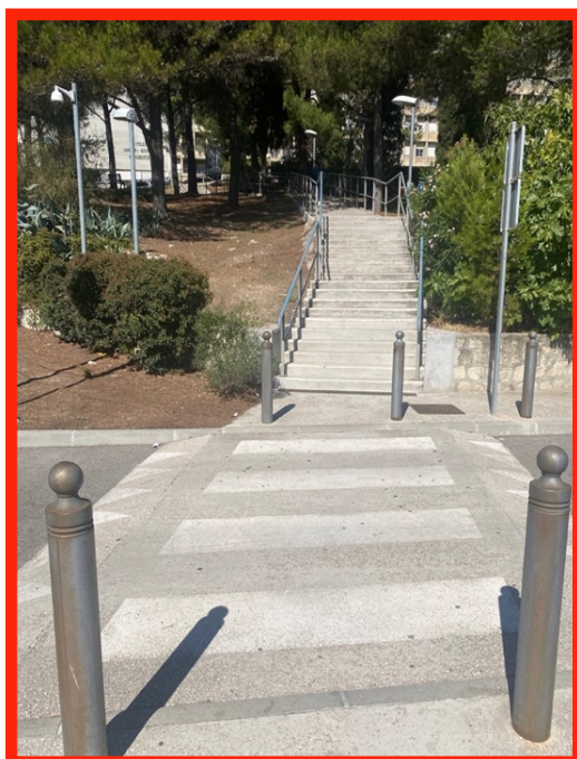
Figure 4 : poteaux de signalisation non contrastés, passage piéton non signalé
