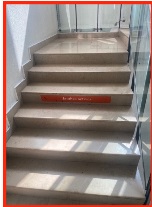
Figure 43 : absence de signalétique au passage à niveau de l'escalier
