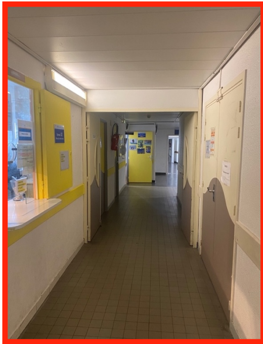
Figure 47 : néon placé en haut du mur n'éclairant que partiellement le couloir
