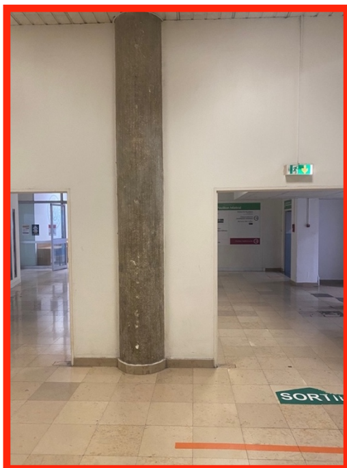
Figure 55 : hall situé devant les ascenseurs où la sortie est mal indiquée
