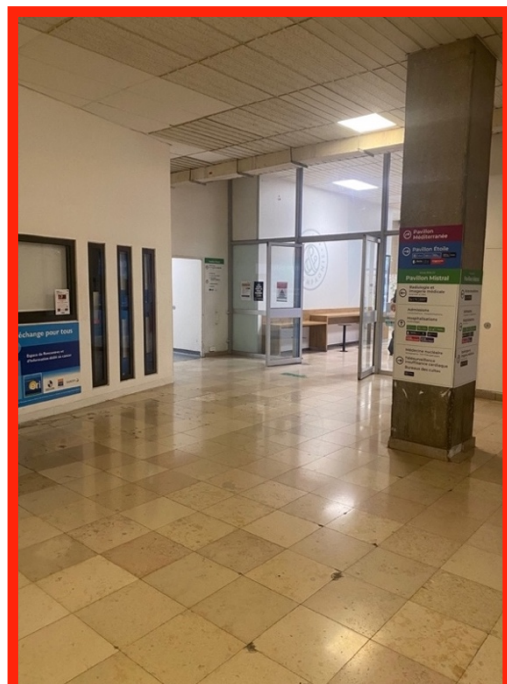
Figure 57 : absence de signalétique de sortie
