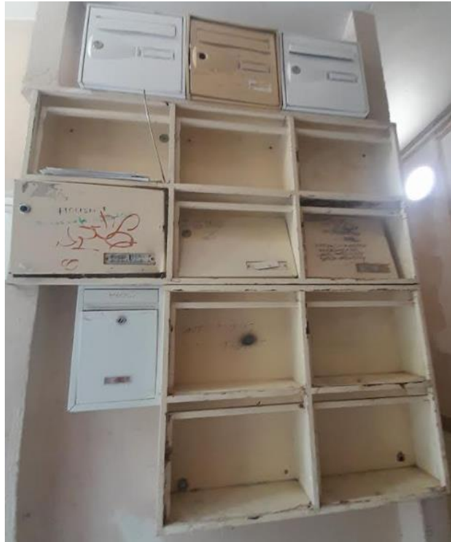
Photo 8 Etat des boîtes aux lettres du bâtiment E (photo personnelle, 2024)
