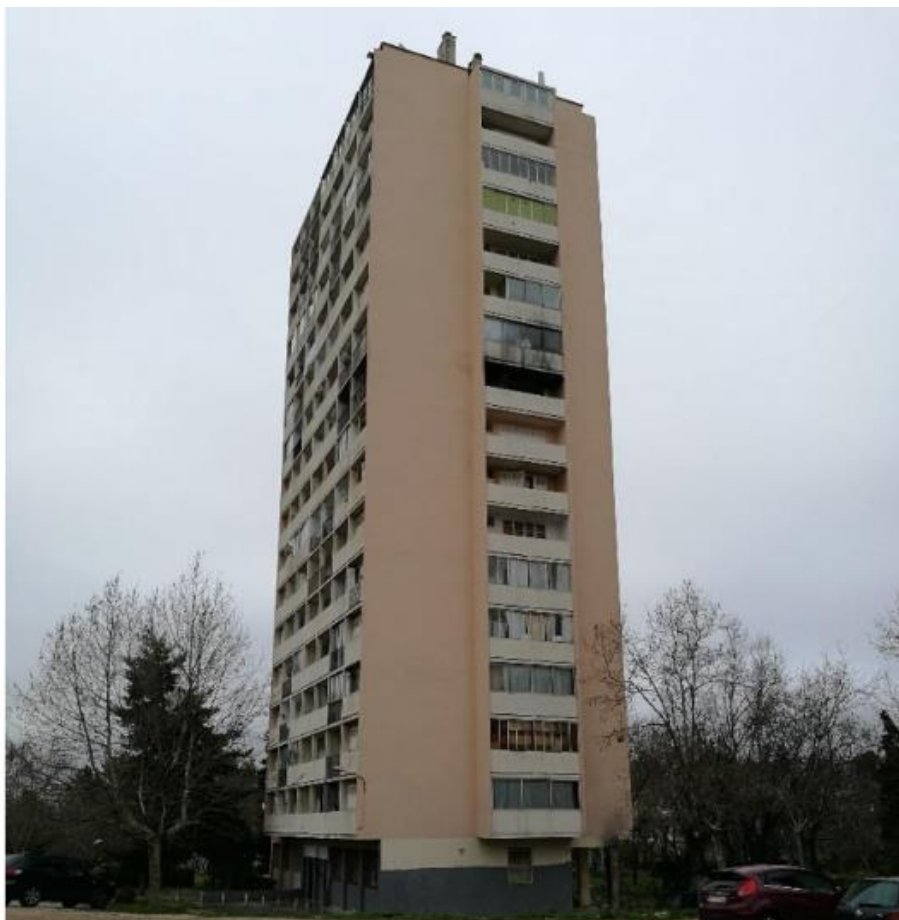
Photo 7 Les façades du bâtiment C noircies par des incendies à répétition (diagnostic technique Citémétrie, 2018)
