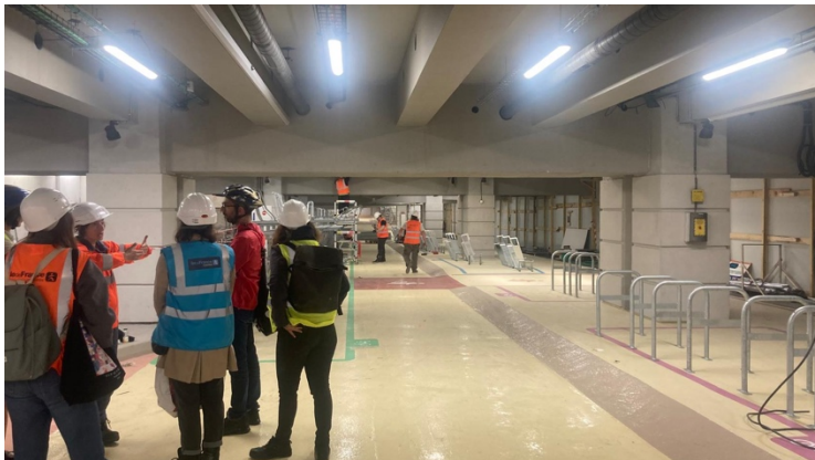
Figure n°17: Visite de chantier du parking vélo Pasteur SNCF G&C avec IDFM, Source : Elise Rougier,
