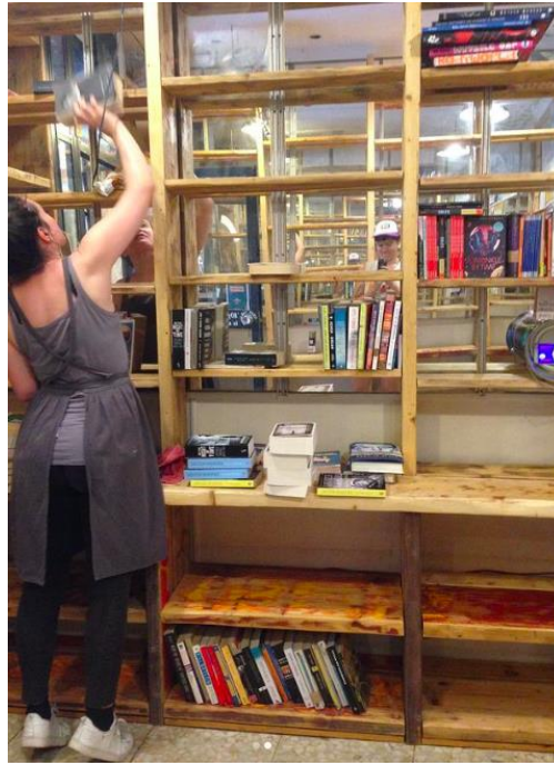
Photo prise le 19/08/19, Paloma Reaño Construction des étagères, Charlotte Delattre, libraire et propriétaire de Desperate Literature
