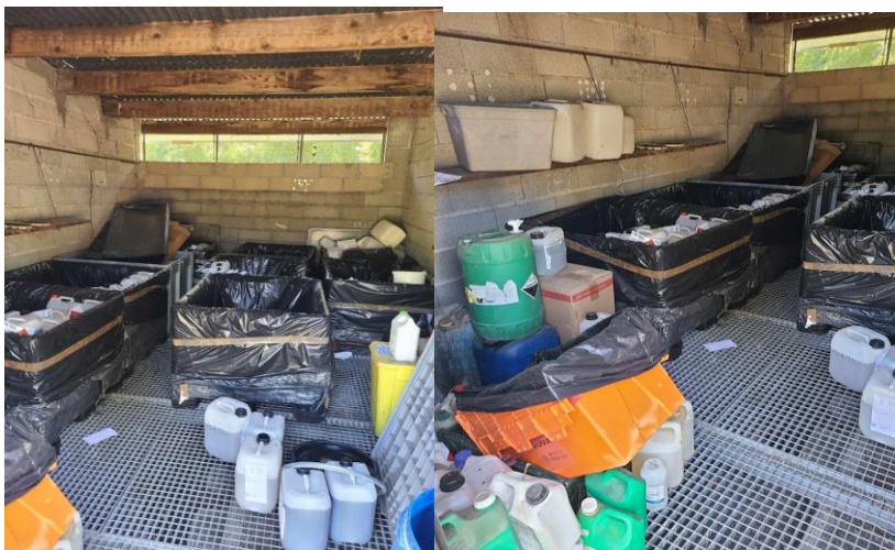
Figure 55 : Intérieur de la soute à DRCT
