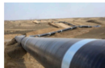
Oléoduc Source : https://africanmanager.com/le-plus-grand-pipeline-dafrique-passera-par-la-tunisie/
