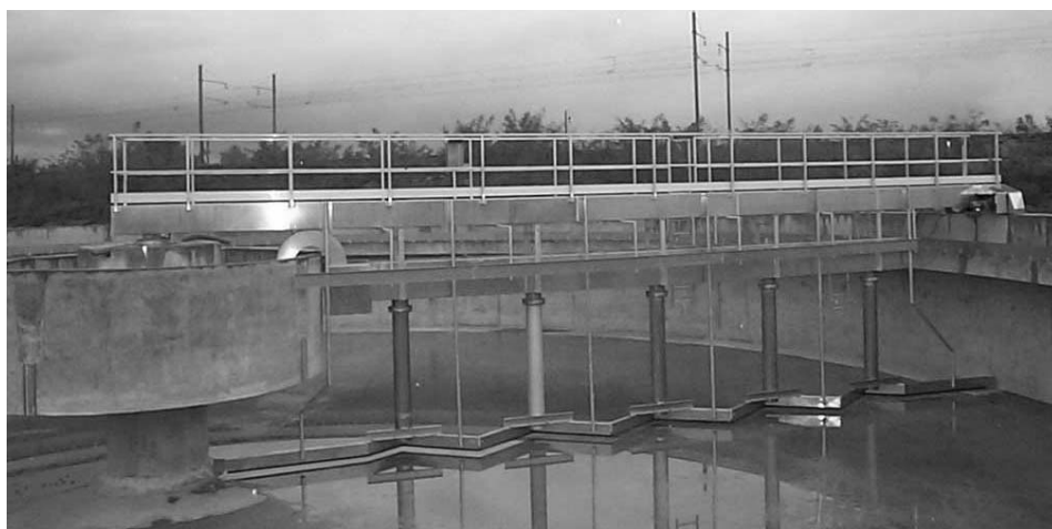
Figure N°44 : Clarificateur à pont suceur
