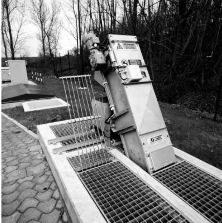
Figure N°23 : Dégrilleur automatique avec by-pass manuel.
