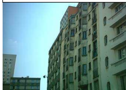
Photo. 6. Immeubles anciens dégradés, rue de Crimée
