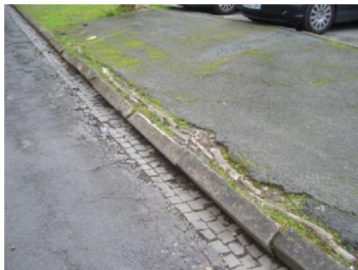
Figure 8 : Accroissement d'une racine de platane à Angers le long d'une bordure béton, provoquant sa déformation. (Gourves A. 2013)
