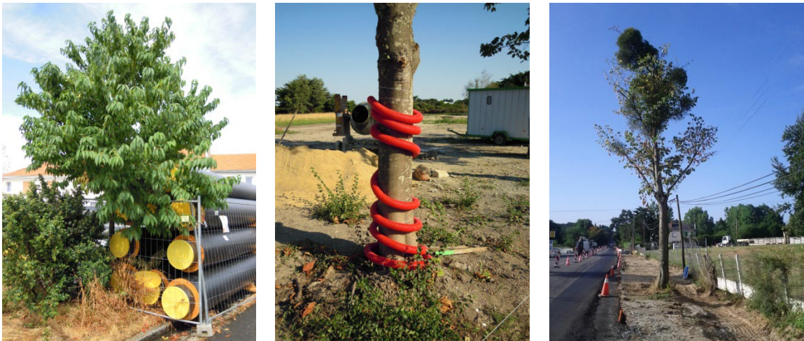
Figure 21 : Exemples de réalisations de chantier non conforme (Paillat, 2013) De gauche à droite : stockage de matériel en pied d'arbre, en appui sur le tronc ; protection individuelle du tronc incomplet ; tranchée en pied d'arbre à moins de 50 cm du tronc.
