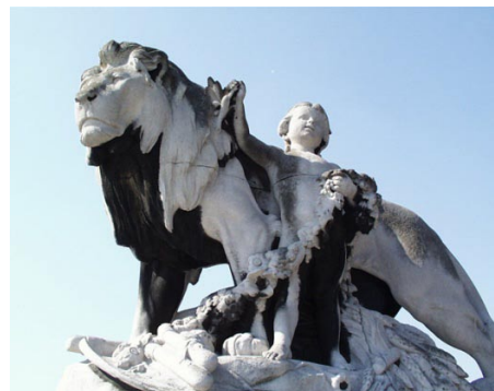
Figure 4 : Dépôt de particules sur monument (Pont Alexandre III – Paris). (Airparif)
