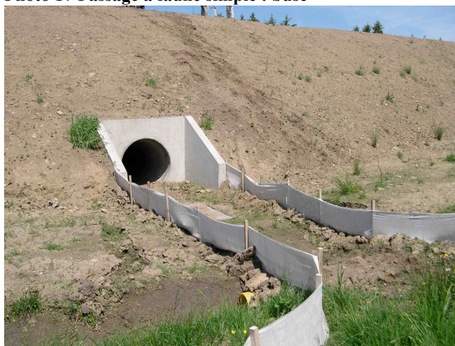
Photo 17 Passage à faune simple : buse
