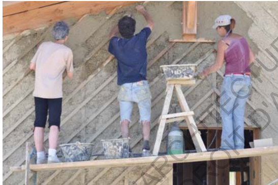
Figure 22: Enduit cote extérieur
