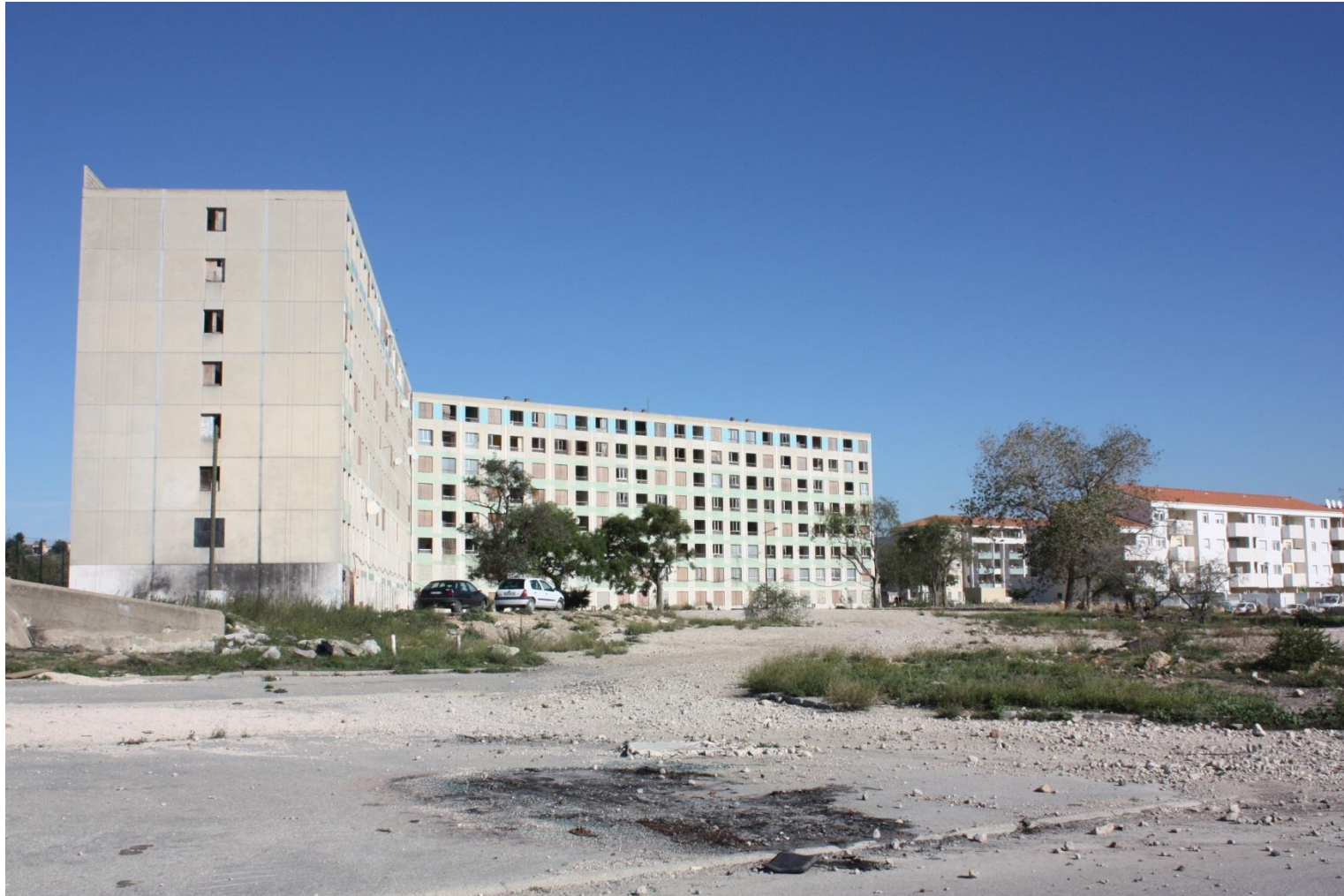
Fig n°18 : Des espaces extérieurs très dégradés et à l'aménagement inexistant au Plan d'Aou à Marseille
