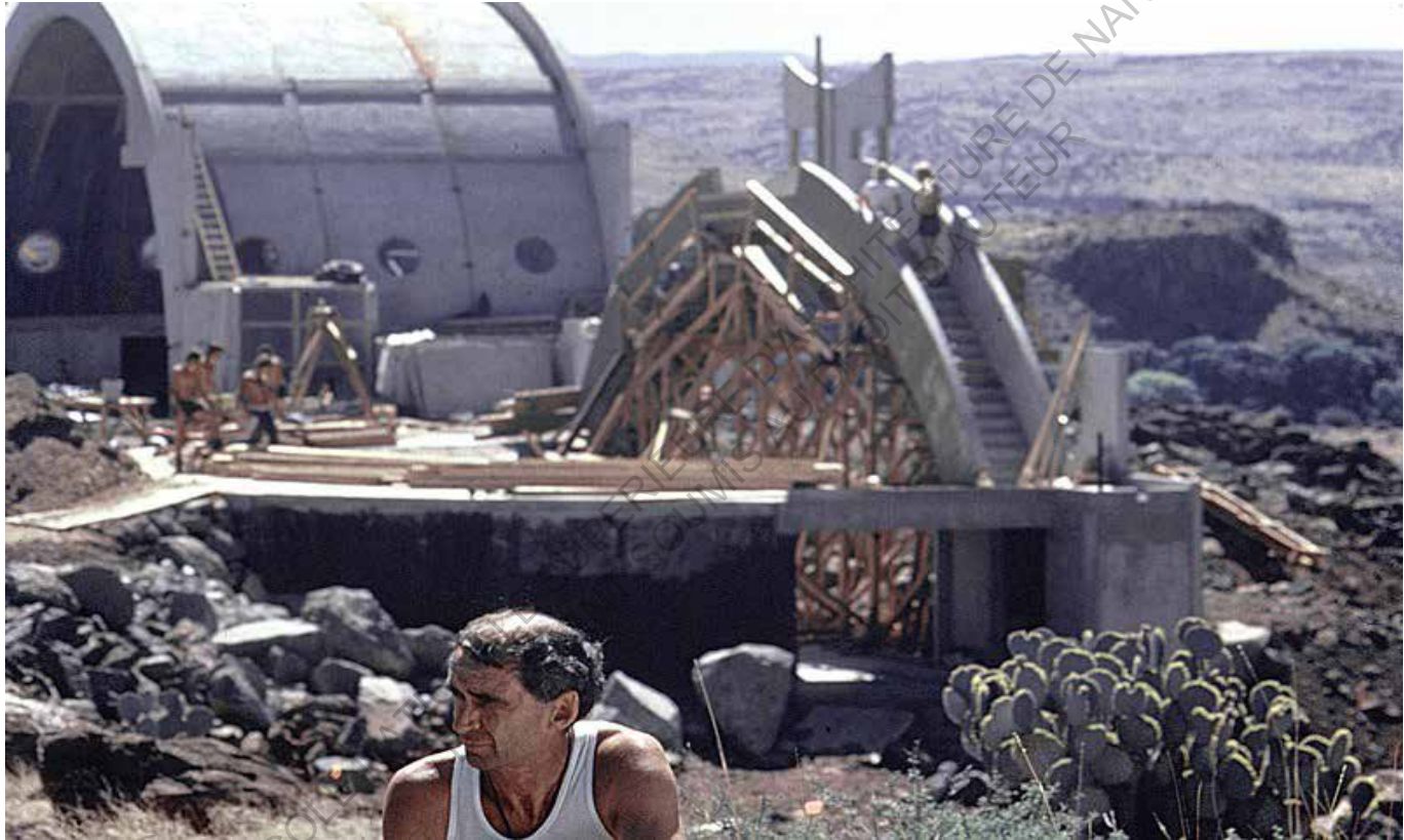
La construction du Ceramics Apse, P.Soleri a toujours prit l'initiative de chantier [93]
