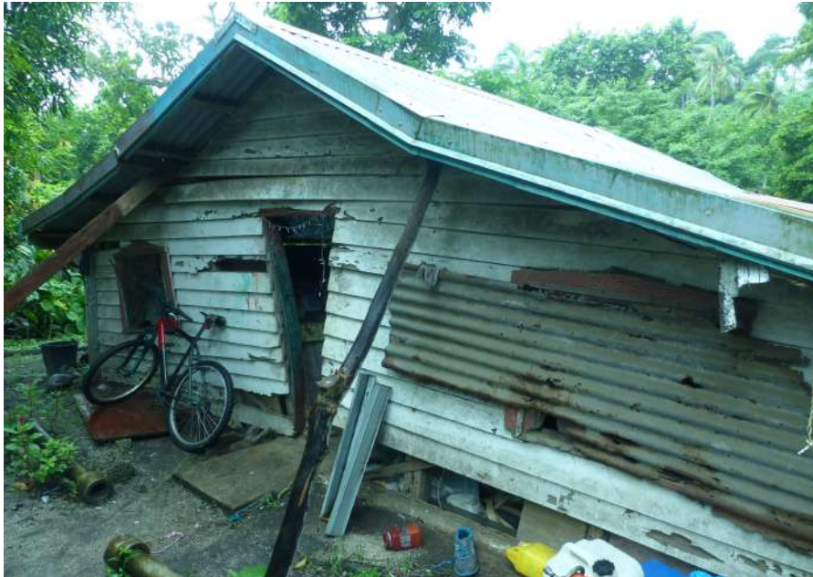
Figure 13 - Structure toujours habitée, fortement endommagée par le cyclone Pam à l'ouest d'Isangel, Tanna (Crédit photo : T.Vauthier)
