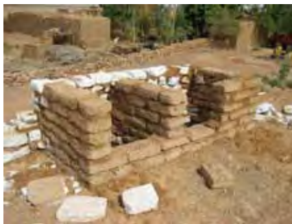
cheminées de ventilation
