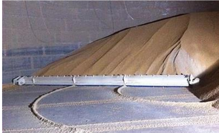
Figure 15 : Exemple de vis balayeuse présente à l'intérieur des silos de graine (morillon Systems, 2023).
