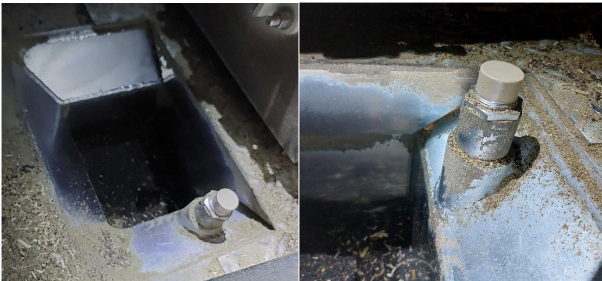
Figure 24 : Capteur NI500A installé à l'intérieur des silos de graines de l'usine de Montoir de Bretagne pour l'arrêt de la vis balayeuse.
